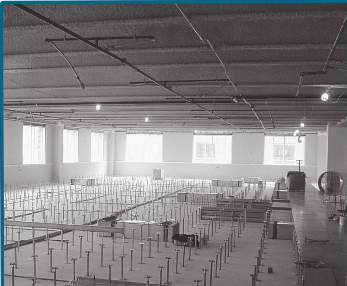
Ejemplo de piso técnico.
