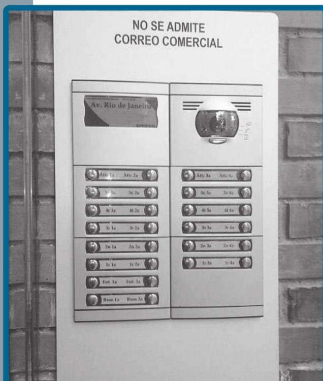
Un videoportero gestiona las llamadas que se hacen y controla el acceso, mediante la comunicación audiovisual interior/exterior.
